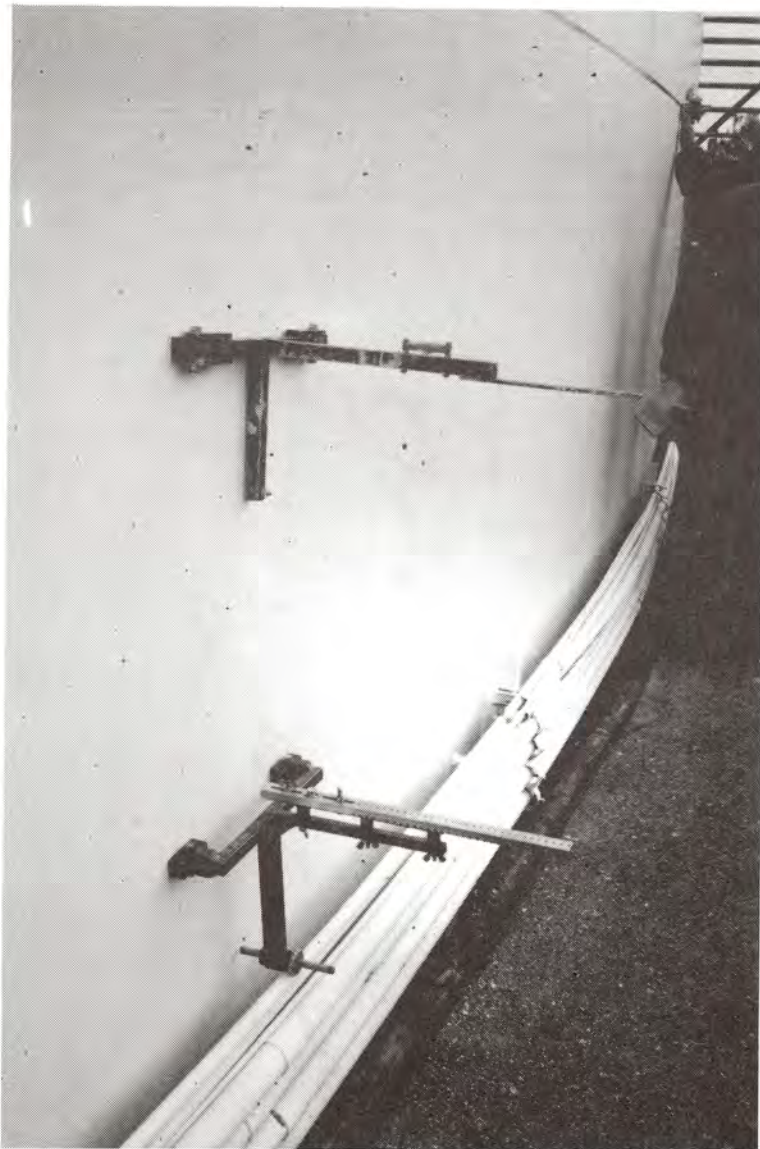
รูปที่ 108 การจัดวางอุปกรณ์สำหรับทำ special plumbing แต่อุปกรณ์ชุดบนจริงๆ แล้วต้องอยู่เหนือระดับเส้น reference circumference
